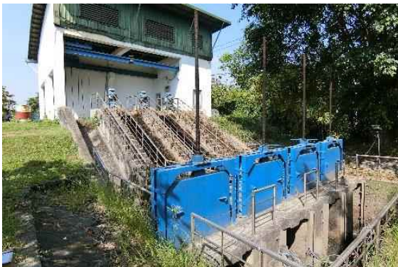
ビンフン下水処理施設 下水取り込み口
